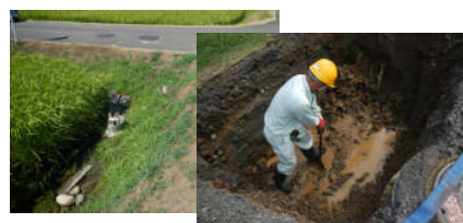
緊急No.2 漏水箇所確定のため試掘を行う。原因は地下水と判明（和知地内）
