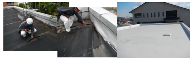
通常整備No.1 連合事務所屋上の防水シート劣化による防水改修改修工事
